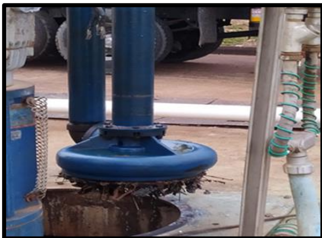
Figura 6. Bomba sumergible del sumidero BU0505.
