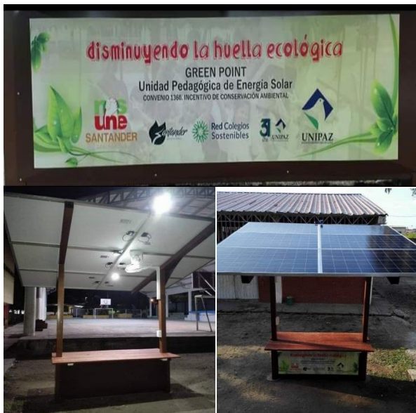
Fotografía 10: Paneles Solares GREEN POINT ubicados en sede A y sede B enfoque ecológico Colegio Integrado del Carare (unidad pedagógica de energía solar) gestión con la Universidad UNIPAZ.
