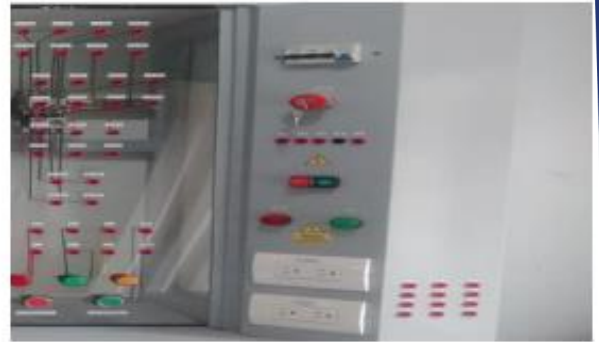
Fig 4. Equipos de Potencia para el SPC
