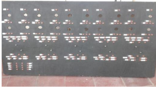
Fig. 2. Tableros de control otras instituciones
